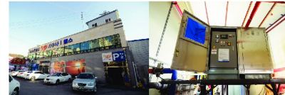
폐수열 히트펌프 50RT×1대 지역 : 진주 | 시설명 : 온천 / 사우나 | 용도 : 목욕탕
