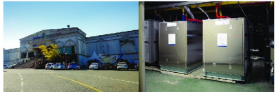
폐수열 히트펌프 50RT×2대 지역 : 사천 | 시설명 : 온천 / 수영장 | 용도 : 목욕탕
