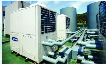
공기열 20RT×4대 지 역 : 영천 시설명 : 요양병원 용 도 : 의료시설
