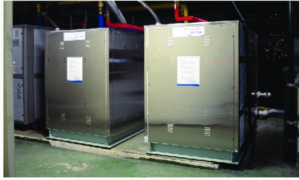
해수열 히트펌프 50RT×2대 지 역 : 사천 시설명 : 온천 / 수영장 용 도 : 목욕탕
