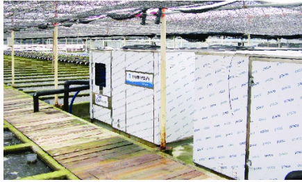
해수열 히트펌프 70RT×3대 지 역 : 완도 어 종 : 전복
