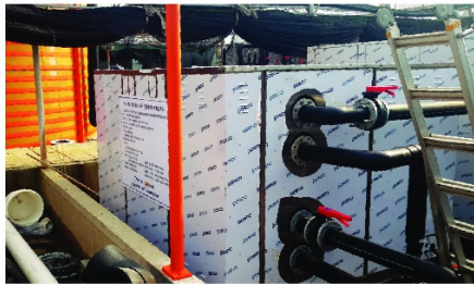
해수열 히트펌프 70RT×2대 지 역 : 완도 어 종 : 전복
